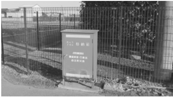
初期消火対策としての役割を担う消防ホース格納箱
