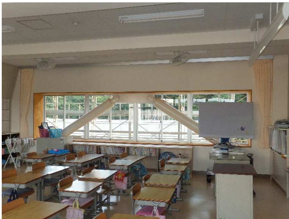
大宝小学校 教室内に設置された耐震ブレース
