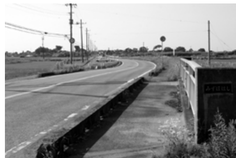
大雨により冠水した瑞穂橋西側
