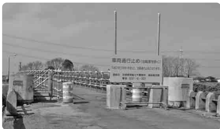
旧長塚橋が車両の全面通行止め
