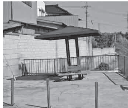
地盤沈下による東屋の傾き(本宗道地内)
