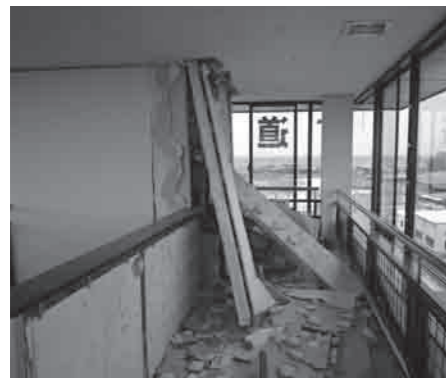
壁の崩落(道の駅しもつま)
