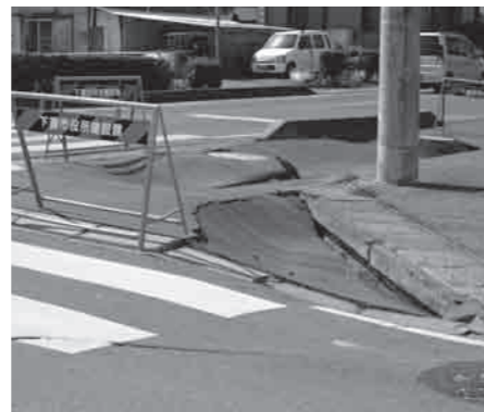
道路の陥没(本宿町地内)
