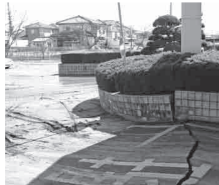
地盤沈下・液状化(千代川庁舎)
