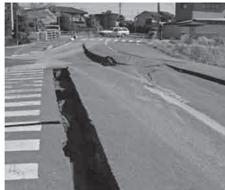
液状化による道路の陥没(鬼怒地内)
