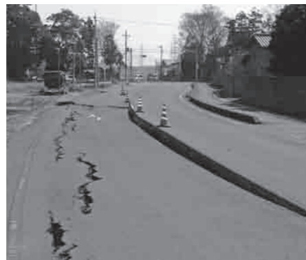
道路の陥没・断裂(山尻地内)
