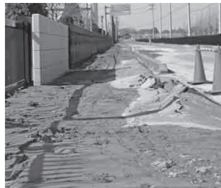
液状化・地盤の隆起(ほっとランドきぬ前)
