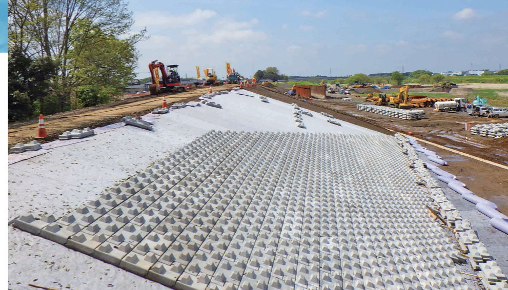
堤防決壊箇所で行われる復旧工事（4月22日、常総市三坂町で）
