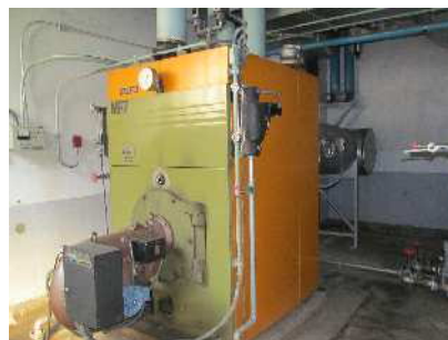
昭和 44 年から稼働しているボイラー
