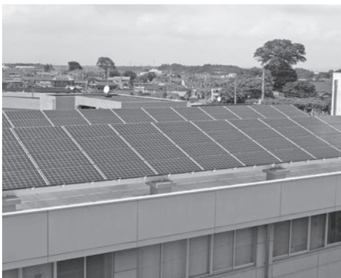
急速に普及拡大している太陽光発電施設
