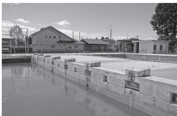
老朽化が進む市内学校プール
