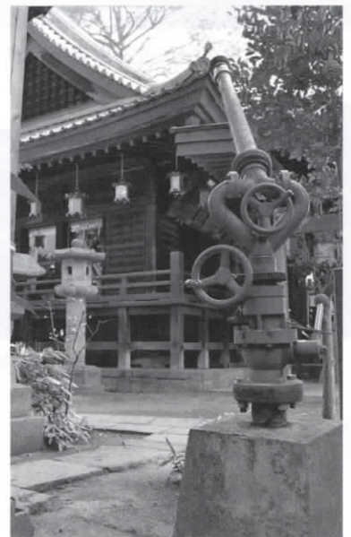
常時文化財を見守っている屋外消火栓設備（放水銃）
