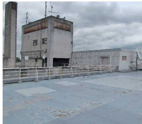
屋上防水の劣化
