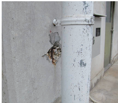
外壁コンクリートの爆裂
