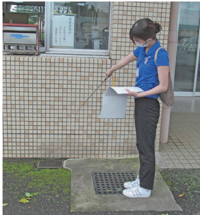
タイルが剥がれる可能性がないか、打診棒でタイルの浮きを確認する。
