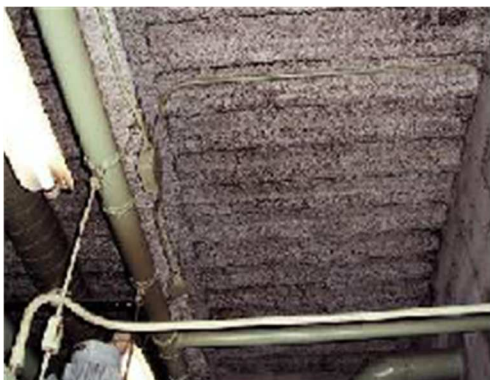
石綿含有吹付けロックウール
