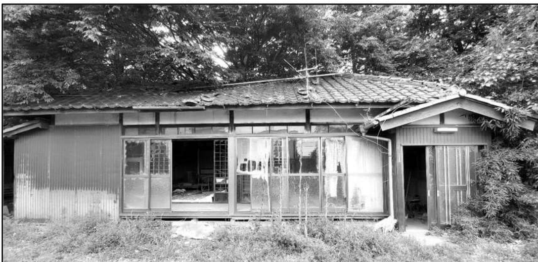
長期間管理されず、老朽化が進んだ空家等
