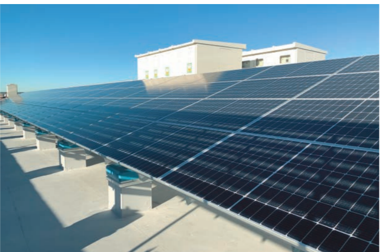
屋上 太陽光パネル
