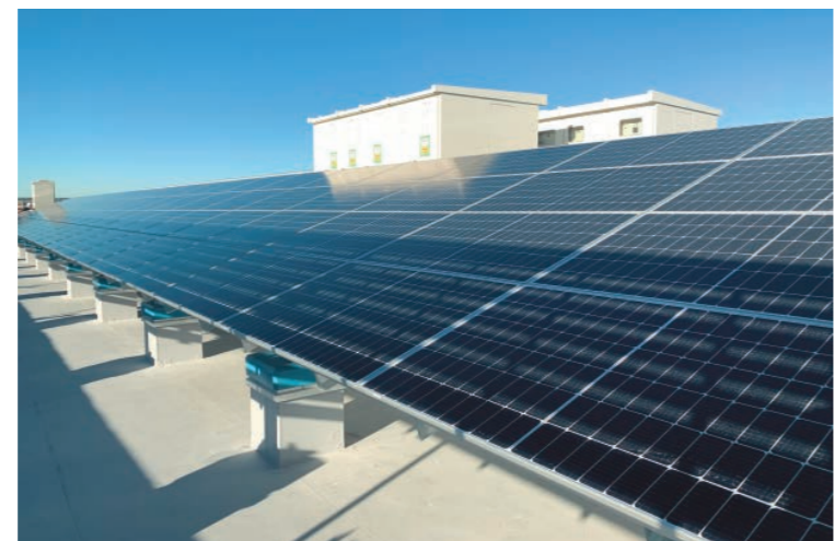
屋上 太陽光パネル
