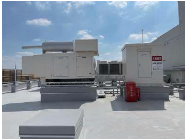
非常用発電機
