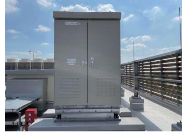
蓄電システム
