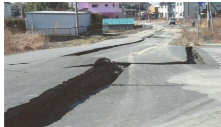
東日本大震災・下妻市内の被害の様子(2011年)
